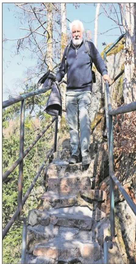
Dieser Bereich der Treppe war kaputt. Nun sind die Stufen zur Freude von Hansjörg Willig ausgebessert. Fotos: Reith
