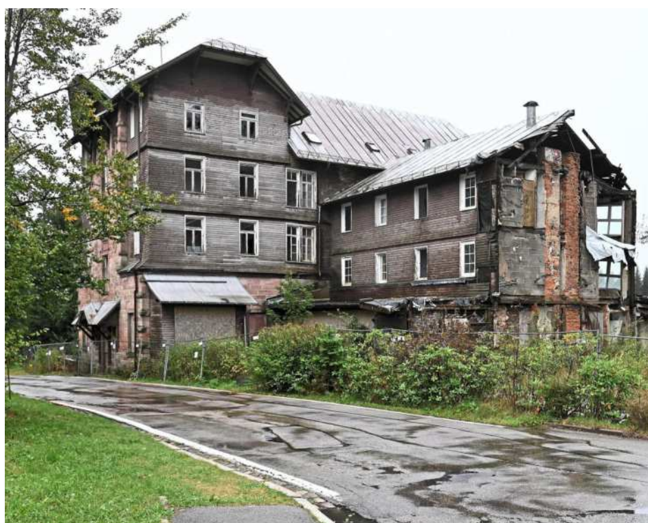
Schandfleck: Die Kurhausruine Hundseck ist nach dem Teilabriss 2012 erneut einsturzgefährdet. Der Abriss des rechten Fachwerktraktes ist geplant. Fotos: Ulrich Coenen
